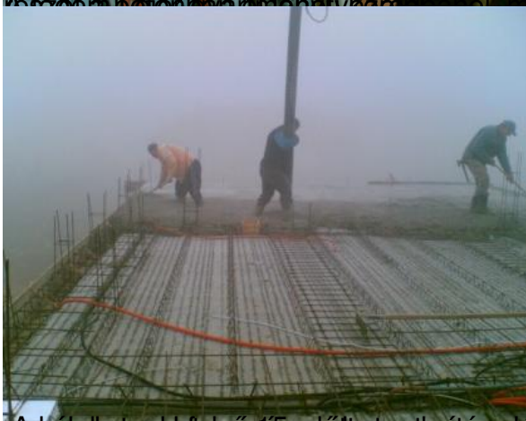
A képek a lefektetés előbetonozás és a szivattyús technológiával került elkészítésre. A
