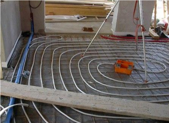
Előre elkészített hővezető rétegű padlófűtés, a padlófűtés csatlakozásai a falon keresztül a szomszédos szobába vezetnek.
