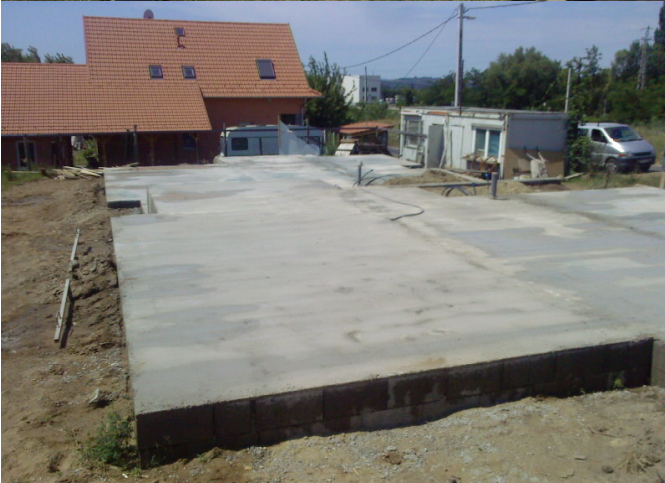
Az alapítványok teljes körű átadását követően az alapítványok körüli területet aszfalttal burkolni fogjuk.
